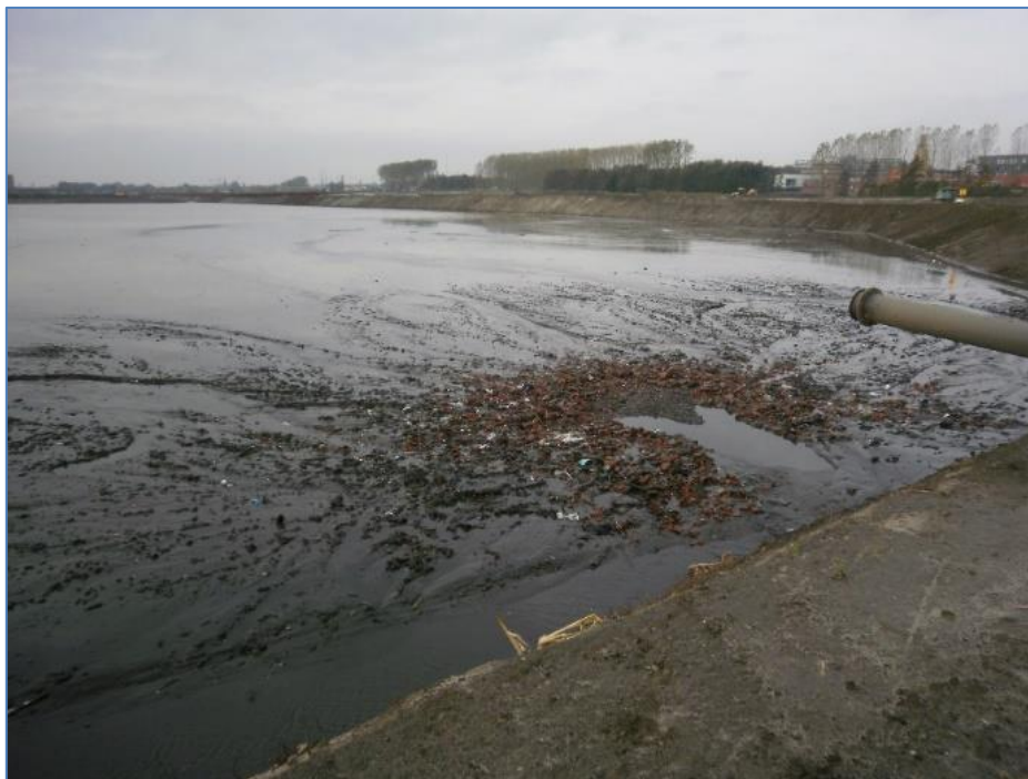
Afbeelding 5.2: grof vuil bij inspuitspunt baggerdepot. Bron: Aannemingsbedrijf Verboon Maasland B.V.
